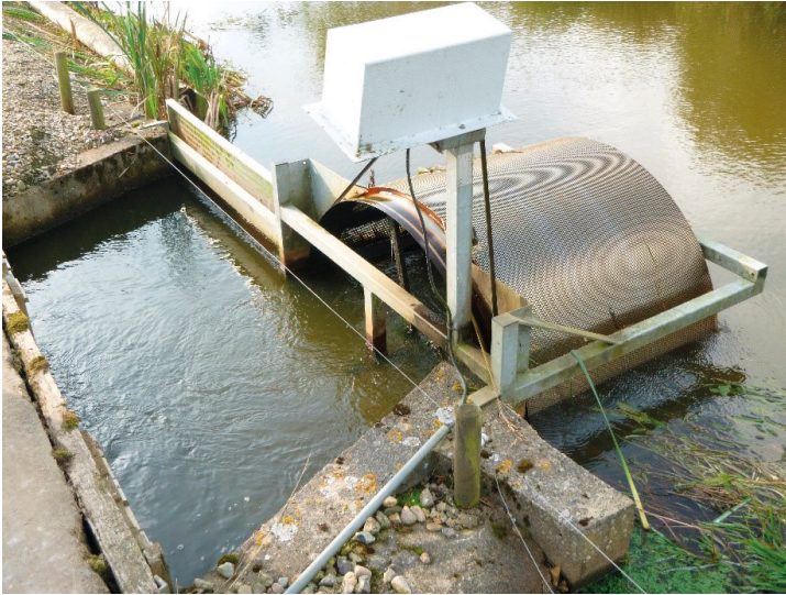
Obr. 3: Jedna z možností umístění mechanické filtrace na přítoku z malé říčky do chovného systému.
