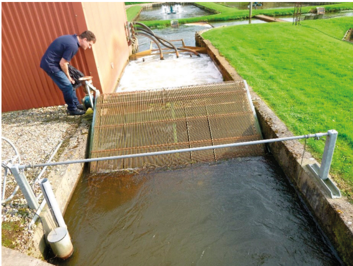
Obr. 4: Česlová stěna a následné provzdušňování
